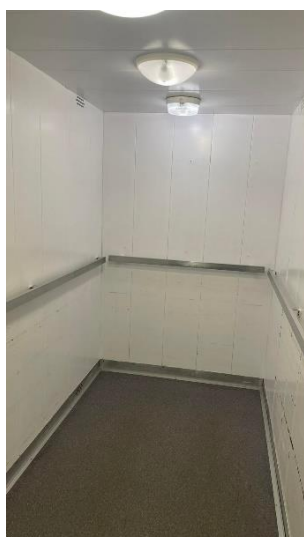
Zdjęcie nr 15: Komunikacja pionowa - kabina windy
